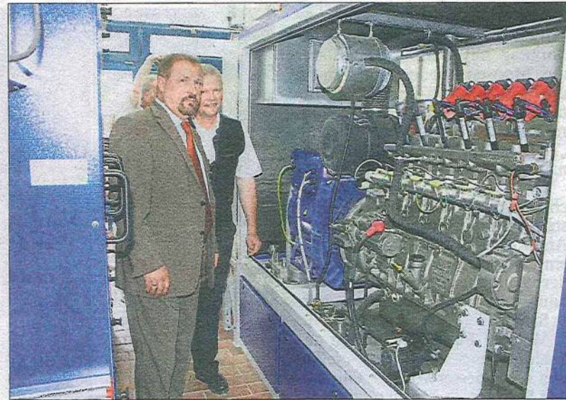
Hocheffizient arbeitet die neue Anlage, die mit neuester Technik ausgestattet ist. Mit den beiden Blockheizkraftwerken können täglich 1300 Kilowattstunden Strom und rund 2000 Kilowattstunden Wärme erzeugt werden. – Fotos: Stronk
